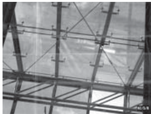
5. ábra. Egyedi, az építész elképzelései szerint kialakított, I tartókra hegesztett, acélkarokra is szerelhető pontmegfogás. Az Újpest Irodapark Tél utcai épületén a legnagyobb üvegtáblák 1,2 × 4,0 m-esek, melyeket hat belső ponton rögzítettünk (200–420 mm a tábla szélétől). Üveg: a tető 8/12/2x6, a falak 8/12/8 Sunguard Clear napvédő üvegezéssel készültek
