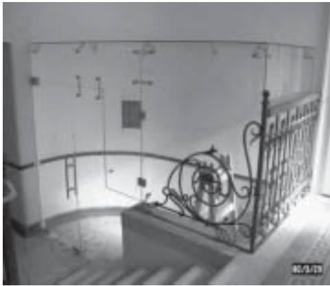
7. ábra. A SZEGO 3000-es beltéri szerelvénycsalád elemeinek segítségével épült meg a Pest Megyei Főügyészség VI., Vörösmarty utca 34/a alatti épületének új portásfülkéje. A műemlék házban az üveg dobozszerkezet világosan jelöli a mai kiegészítést. Üveg: 10 mm, a tető föliázott
